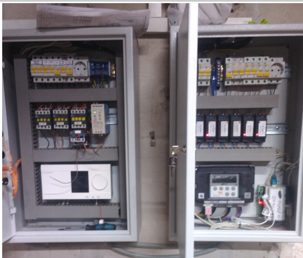
Рис.1 Шкафы автоматизации, в левом Danfoss, в правом ВКТ-9 и контроллер OEMv6. Стадия пусконаладочных работ.
